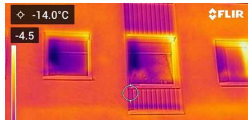
Termografering i Tallbohov efter fasadrenovering och fönsterbyte. Den mörkare färgen visar att det läcker ut mycket mindre värme genom fönster och fasader efter renoveringen.
