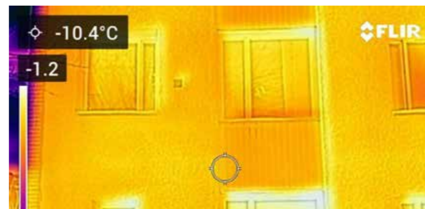
Termografering i Tallbohov före fasadrenovering och fönsterbyte. Den ljusa gula färgen visar att mycket värme läcker ut både genom fönster och fasad.
