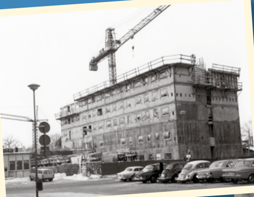
Bilden till vänster: Grunden är på plats. På skylten står det JÄRFÄLLA KOMMUN UPPFÖR POSTHUS JAKOBSBERGS CENTRUM och YNGVE KULLENBERG BYGGNADSAKTIEBOLAG.
